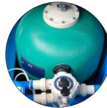
完成雨水深度过滤， 过滤精度50—100微米
